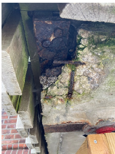
Billede – rust i stålprofiler og afskallet beton
