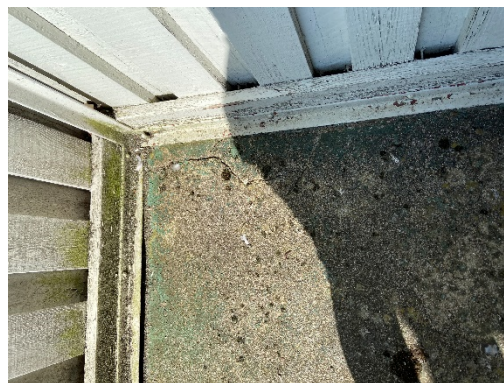
Billede – revner i beton
