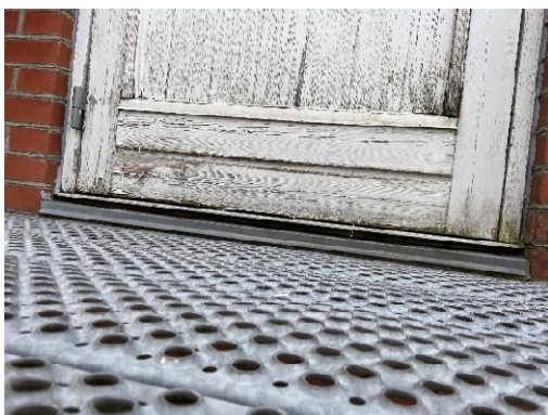
Billede – manglende vedligehold af dør samt begyndende rådskader
