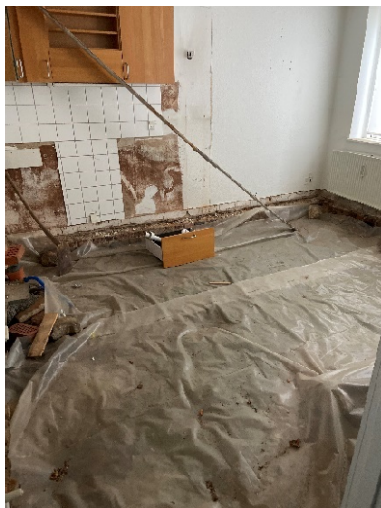
Billede – terrændæk mangler i køkken (stueetagen)
