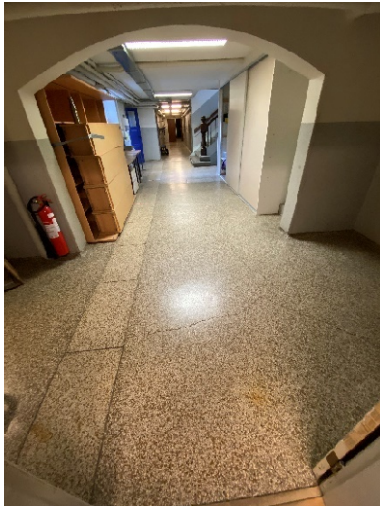
Billede – revner i terrazzo
