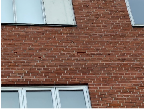
Billede – område med afskallet tegl og udvasket mørtelfuger
