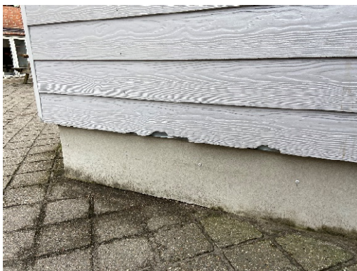
Billede – afbrækkede kanter på facadebeklædning
