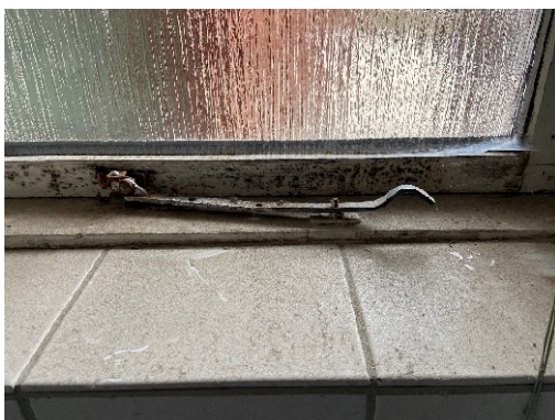
Billede – "sortsværtning" på vindue. (skimmel?)
