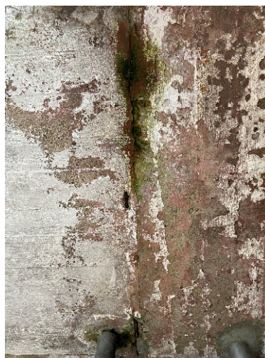
Billede – rust i armering og betonafskalning
