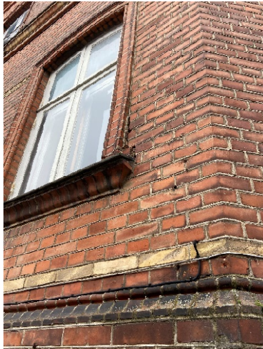
Billede – vinduesfals med løse tegl
