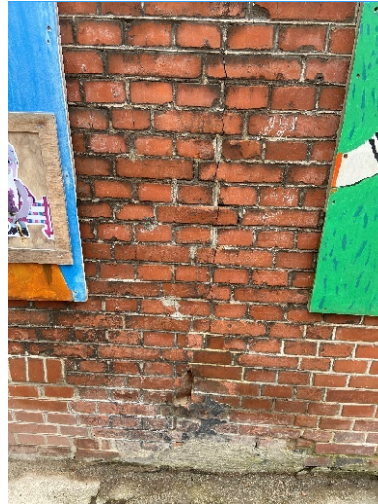
Billede – tegl med revner, afskallet, knækket samt udvaskede mørtelfuger
