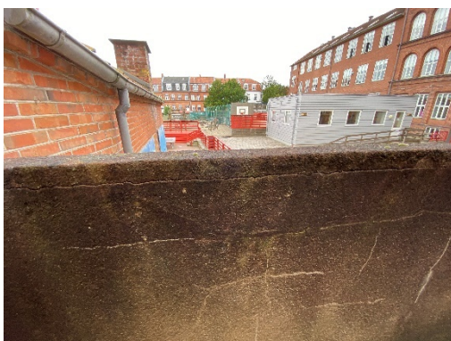
Billede – revner i betonværn
