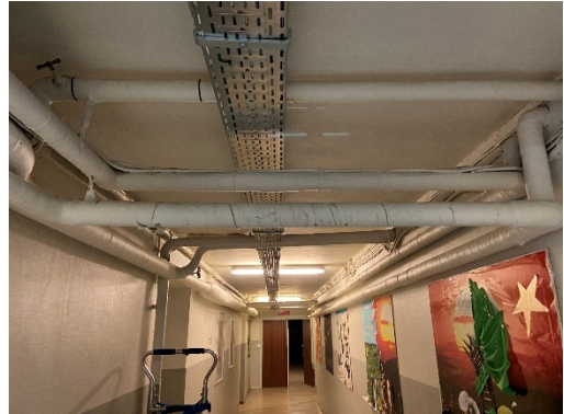
Billede – eksisterende vand- og varmerør med teknisk isolering og lærred
