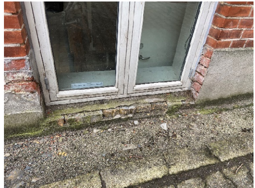
Billede – udvaskede mørtelfuger, revner og afskalninger i sokkelpuds
