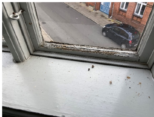
Billede – manglende vedligehold af vindue samt begyndende rådskader
