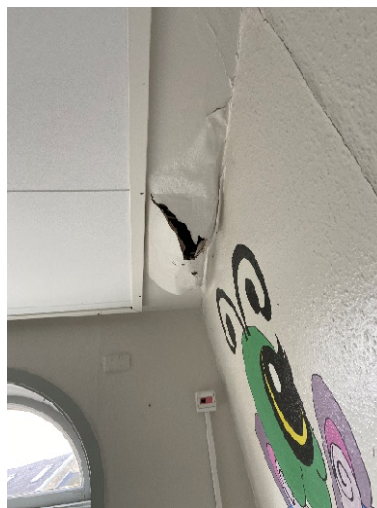
Billede – skader i loft efter utætheder i tagkonstruktionen
