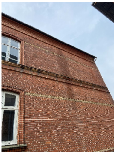
Billede – fugt på facade ved defekt tagrende
